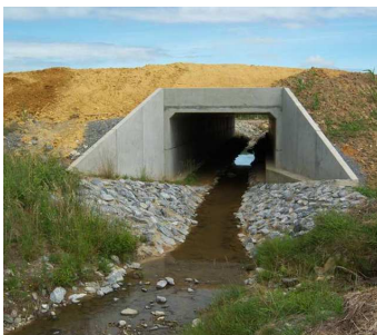
Ouvrage de transparence hydraulique – DLE BPL
